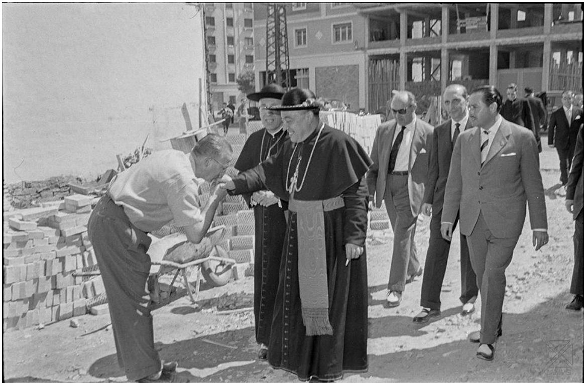
Visita del obispo a las obras de la iglesia de Los Ángeles.1959
