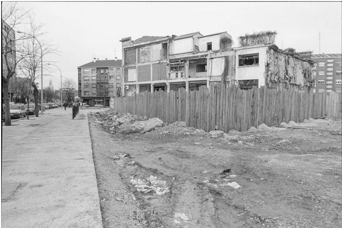
Calle Heraclio Fournier. Y el derribo de la fábrica de 1948. Fecha de la foto el 27 de enero de 1995
