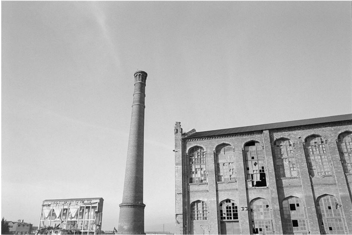
Edificios de la Azucarera Alavesa en ruinas.-29-11-1994
