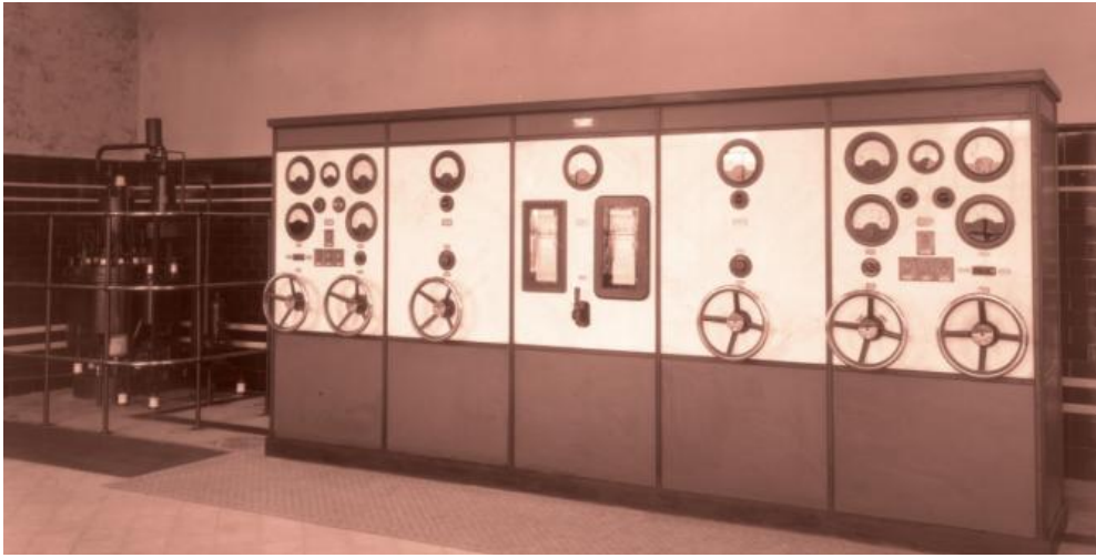
Sala de mandos de la subestación de Burba , en Ancín, Archivo Fundación Sancho el Sabio Fundazioa
