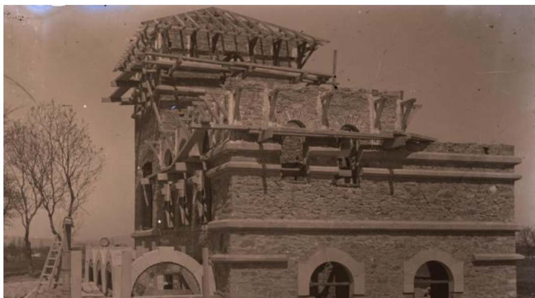
Estación de Olárizu en construcción, año 1923, Archivo Fundación Sancho el Sabio Fundazioa
